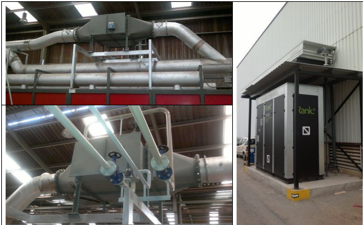
Imágenes de la instalación
